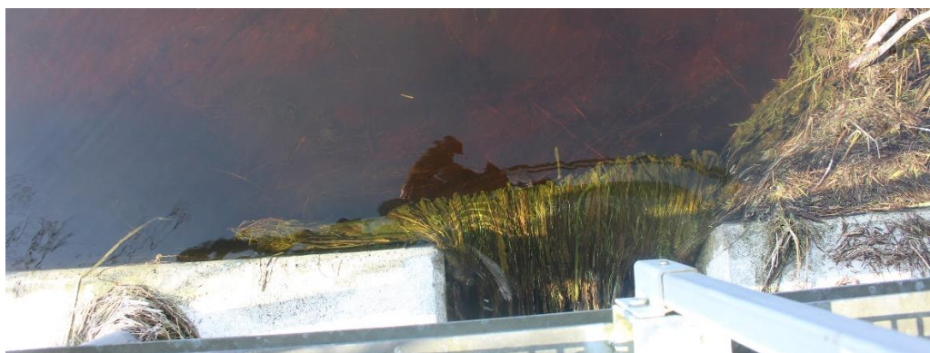
Det nedsänkta utskovet i utloppet av Petgårde träsk är inte anpassat i sin form för att bibehålla vattnet.
