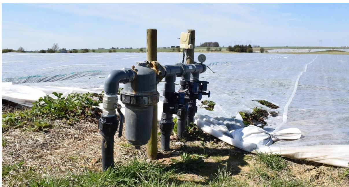
Stamledningen ansluter här till sektionerna ute vid fältet. Bevattningen sker enligt klocka som finns i den lilla vita dosan, som i sin tur är kopplad till de olika sektionernas magnetventiler.
