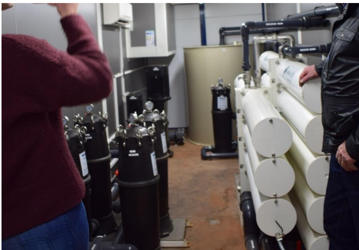
Här en anläggning för omvänd osmos i en brittisk jordgubbsodling.
