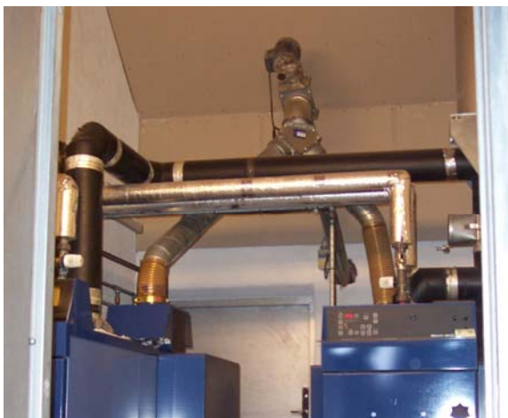
Bild 7. Inmatning till panna från utvändig silo.
