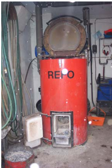
Bild 14. 30 kW panna med bränsleförråd på 250 liter
