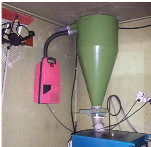
Bild 8. Utrustning för framsugning av spannmål till cyklon i pannrum.
