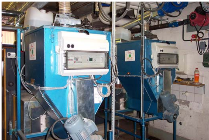
Bild 20. Två brännare gör det möjligt att elda mot varierande effektbehov
