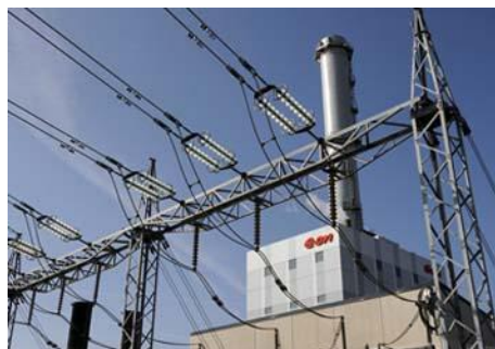
Anläggningar för både topp- och reservkraft samt störningsreserven säkrar elförsörjningen.
